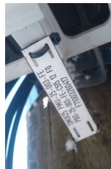
Identification d'un câble posé par le Syndicat mixte au niveau d'un boîtier (étiquette blanche)
