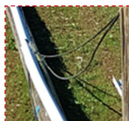
Plusieurs câbles (cuivre et fibre) → infrastructure partagée
