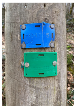
Réseau Syndicat mixte sur poteau Orange avant 2018 => étiquette verte (Syndicat mixte) + étiquette bleue (identification Orange)
