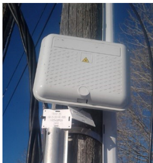
Boîtier optique posé par le Syndicat mixte sur un poteau (étiquette blanche)
