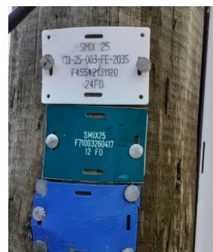
Réseau Syndicat mixte sur poteau Orange déployé en 2 temps. Avant 2018 (étiquette verte) puis après 2018 (étiquette blanche). Etiquette bleue (identification Orange)
