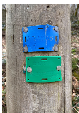
Réseau SMIX sur poteau Orange avant 2018 => étiquette verte (SMIX) + étiquette bleue (identification Orange)
