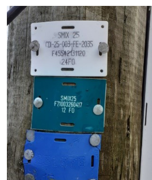
Réseau SMIX sur poteau Orange déployé en 2 temps. Avant 2018 (étiquette verte) puis après 2018 (étiquette blanche). Etiquette bleue (identification Orange)
