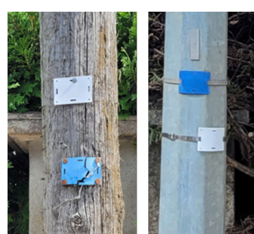
Réseau SMIX sur poteau Orange après 2018 étiquette blanche (SMIX) + étiquette bleue (identification Orange)
