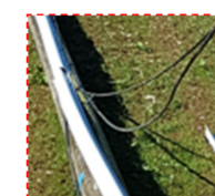
Plusieurs câbles (cuivre et fibre) infrastructure partagée
